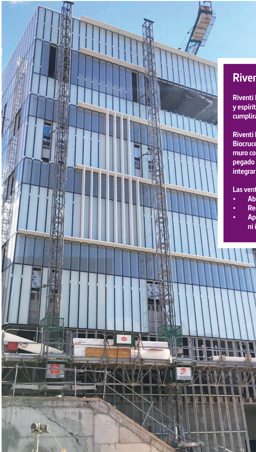
Un instante de la construcción de una de las fachadas del Instituto Biocruces. Foto: Riventi.
